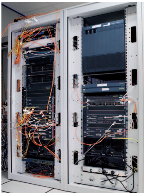
A l'esquerra, els commutadors del CATNIX i de l'Anella de Telvent i, a la dreta, els del Campus Nord.
