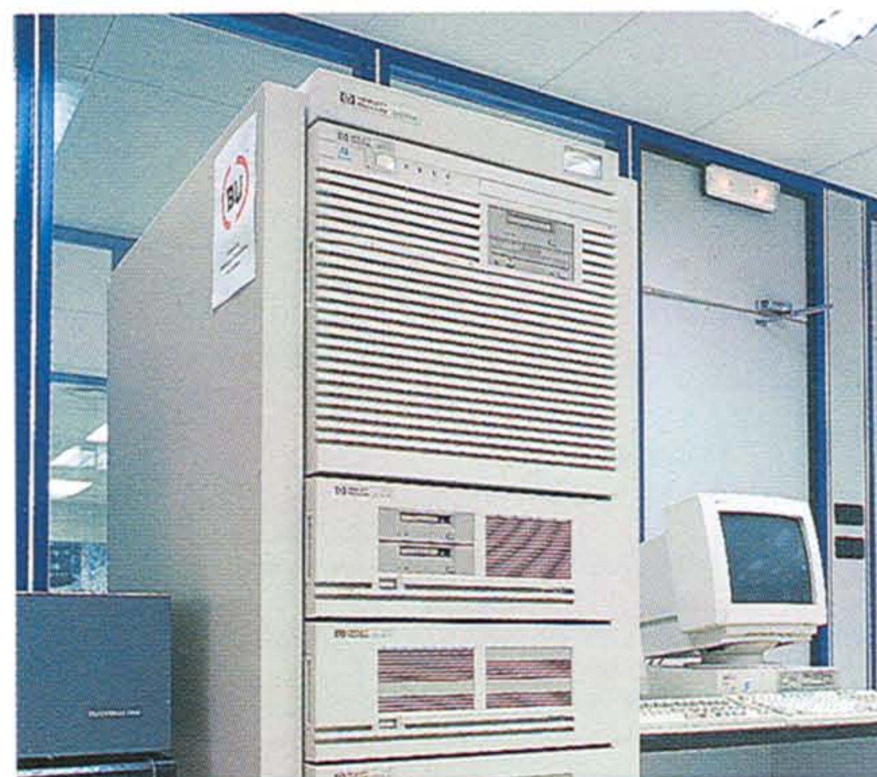
L'ordinador del CBUC instal·lat a l'Edifici Annexus
