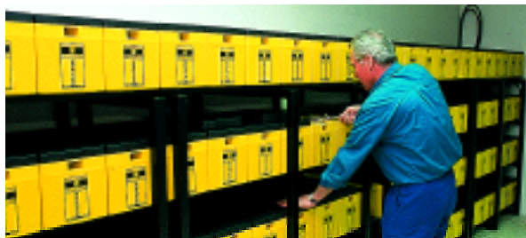
El responsable de manteniment del CESCA a la sala de bateries.
