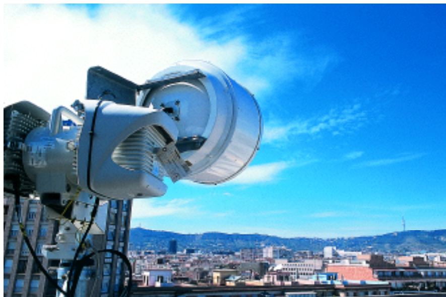
El radioenllaç situat a l'edifici de Política Territorial i Obres Públiques (PTOP).
