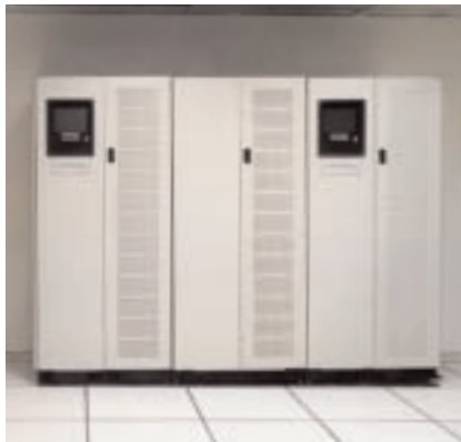
El nou SAI proporciona més fiabilitat i autonomia al maquinari, tant de supercomputació com de comunicacions.
