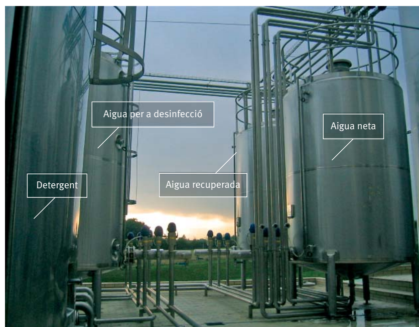
Instal·lació de neteja in situ en una indústria làctia.
