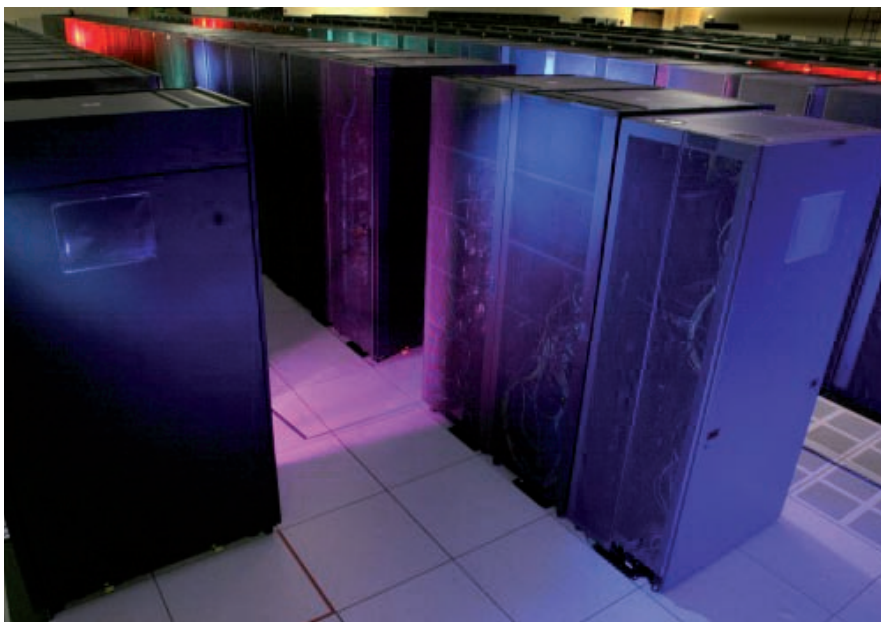
El Roadrunner, instal·lat al Laboratori Nacional de Los Alamos, disposa de 122.400 nuclis.
